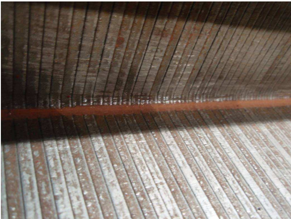
Bild 3: nicht zuzlässige Farbreste im zu prüfenden Radius
