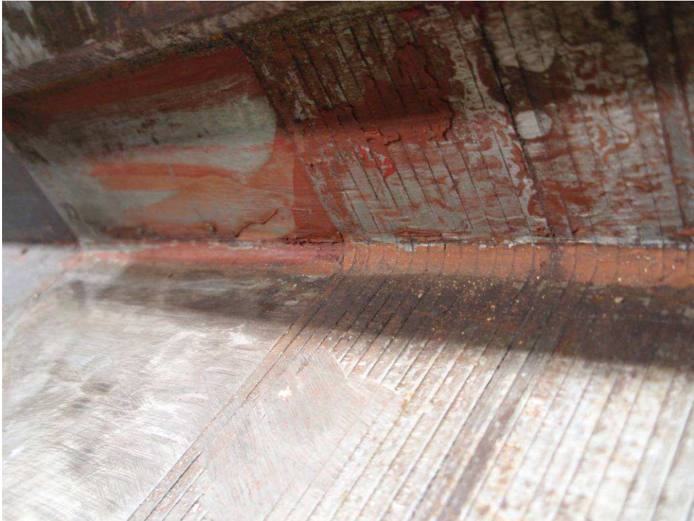
Bild 4: lose Farbreste im Prüfbereich, nicht geeignet zur Prüfung
