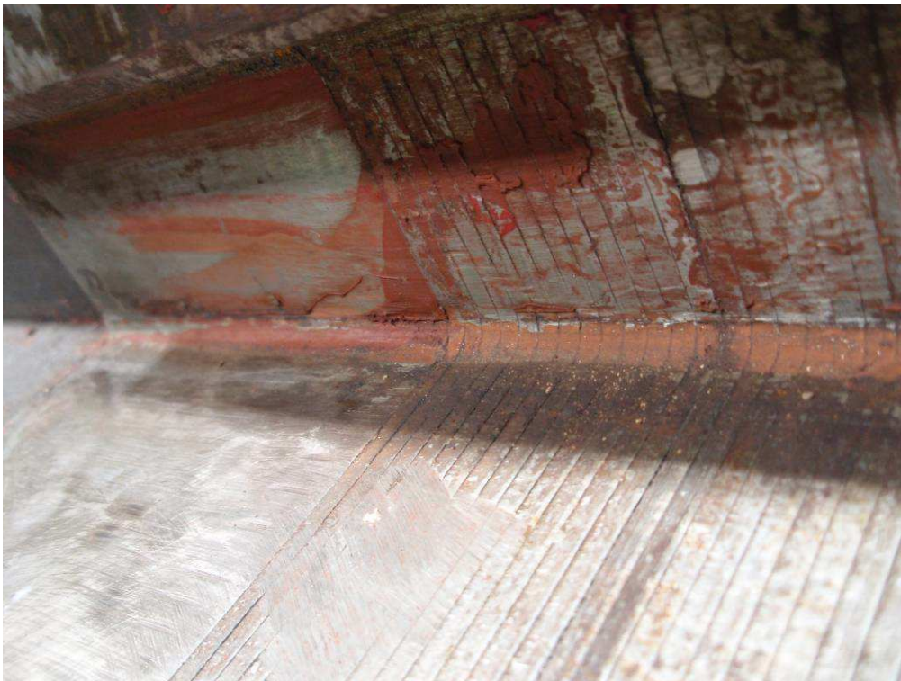
Bild 5: lose Farbreste im Prüfbereich, nicht geeignet zur Prüfung
